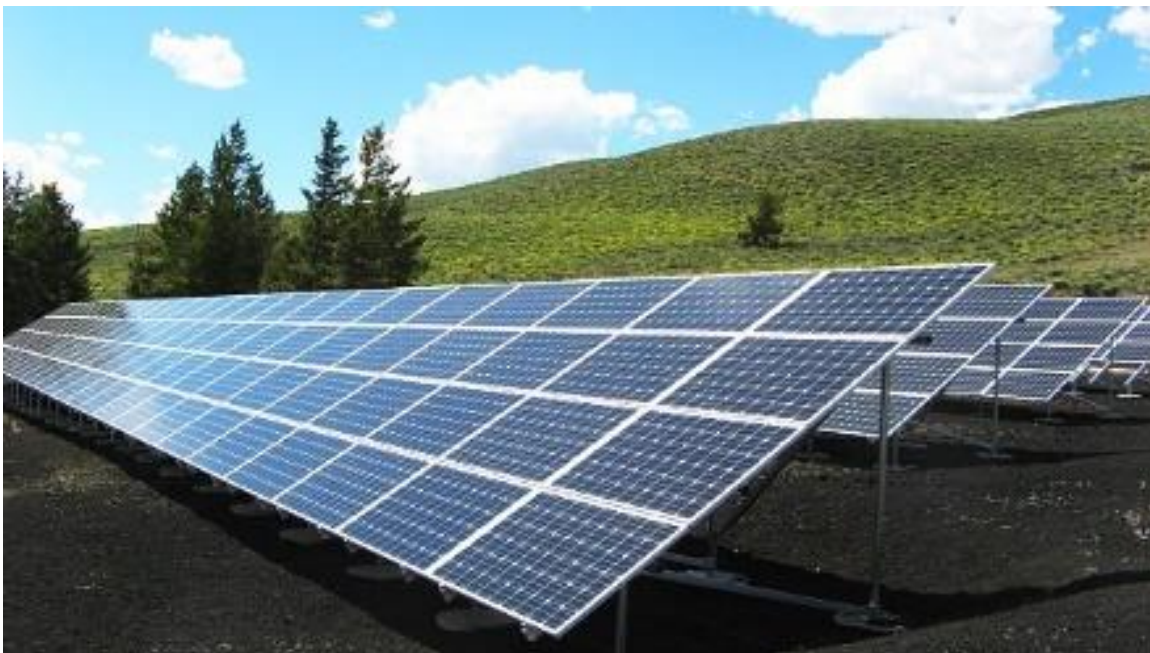
Grande centrale solaire par la Société Green Yellow à Ambatolampy (20MW d'électricité renouvelable pour alimenter 50000 foyers
